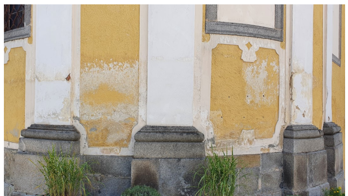
Durch die aufsteigende Feuchtigkeit ist das Mauerwerk stark in Mitleidenschaft gezogen worden.
