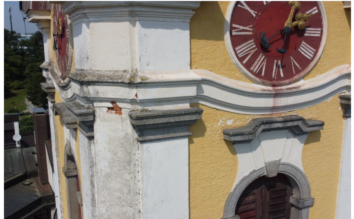
Am Glockenturm bröckelt der Putz, das Ziffernblatt der Turmuhr verliert Farbe. Auch die Zeiger sind alt und brüchig.
