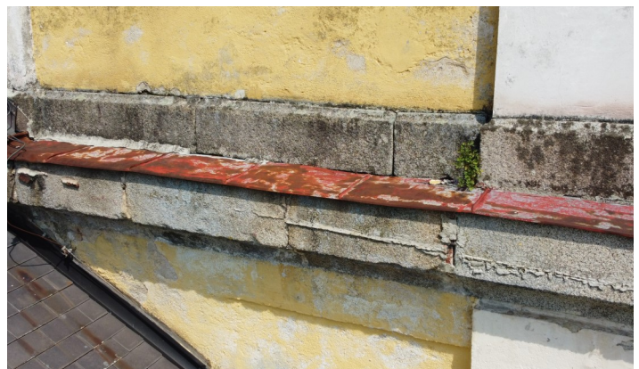
Die Natursteinelemente sind von Flechten überwachsen und ausgewaschen.
