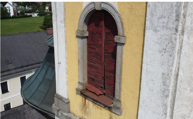
Die Schallläden des Turmes sind morsch und nicht mehr zu bewegen.
