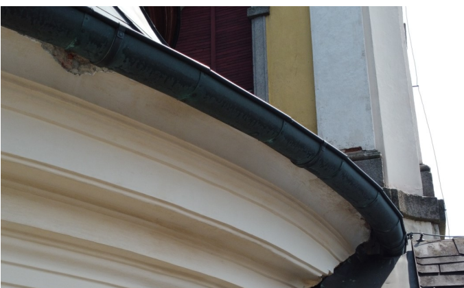
Auch die Dachrinne ist desolat, das tropfende Wasser schädigt die Bausubstanz fortlaufend.
