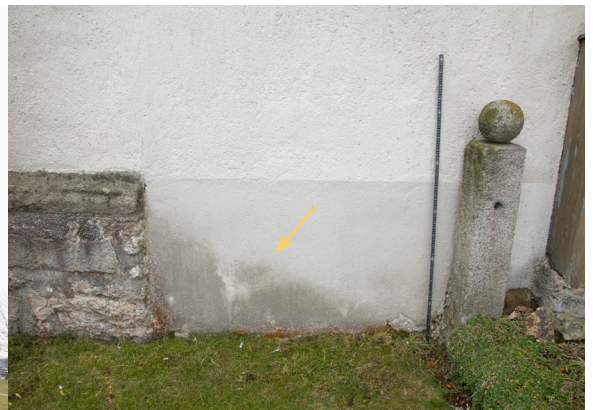
Abb. 07 Feuchtflecken im Sockelputzbereich an der Südostfassadenseite (IMG_9440.tif)
