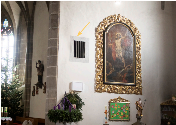
Abb. 26 Einblasheizung an der Chorwand zum Kirchenschiff (IMG_9496.tif)
