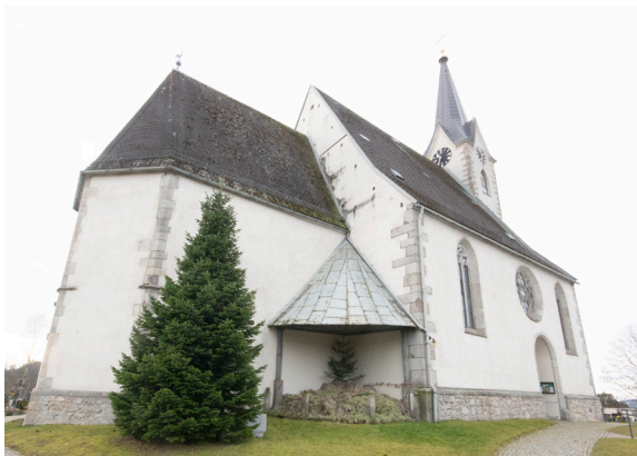
Abb. 06 Direkter Erdreichanschluß an das Mauerwerk und eine neu verputzte, überdachte Grotte an der Ostfassadenseite (IMG_9445.tif)
