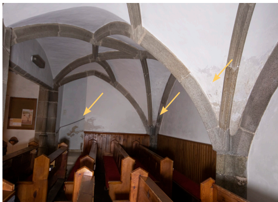
Abb. 18 Salzsäden unter der Orgelempore (IMG_9489.tif)
