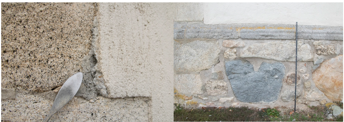
Abb. 04 Kalkzementputz auf Zementvorspritzer (IMG_9439. Abb. 05 Zementputz an der Westfassade (IMG_9438.tif)
