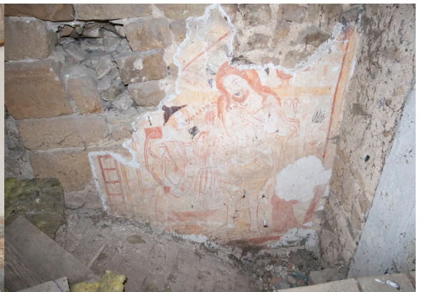
Abb. 29 Wandmalereifragment im Dachbodenbereich des Sakristeianbaus (IMG_9416.tif)
