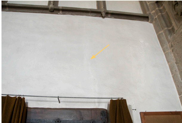
Abb. 45 Statischer Riss an der Chornordwand über Eingang (IMG_9519.tif)
