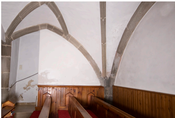
Abb. 42 Salz- und Feuchteschäden unterhalb der Orgelempore (IMG_9491.tif)
