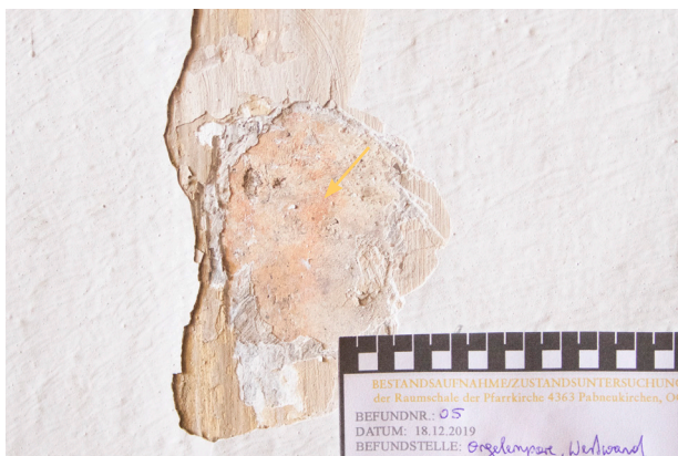
Abb. 34 Befund 05: Westwand auf Orgelempore, möglicherweise rote Farbreste einer spätgotischen Fassung (IMG_9515.tif)
