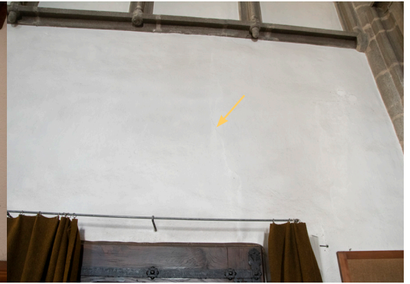
Abb. 23 Statischer Riss über Eingangsportal an der Nordwand (IMG_9519.tif)
