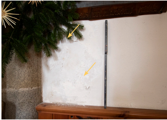
Abb. 22 Feuchteschaden über Holzvertäfelung an der Süd- wand im Kirchenschiff (IMG_9469.tif)
