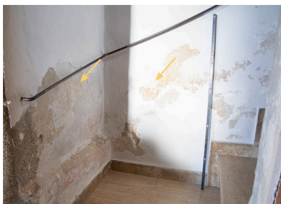
Abb. 20 Salzsäden und Feuchtflecken im Sockelbereich des Emporenaufgangs (IMG_8724.tif)
