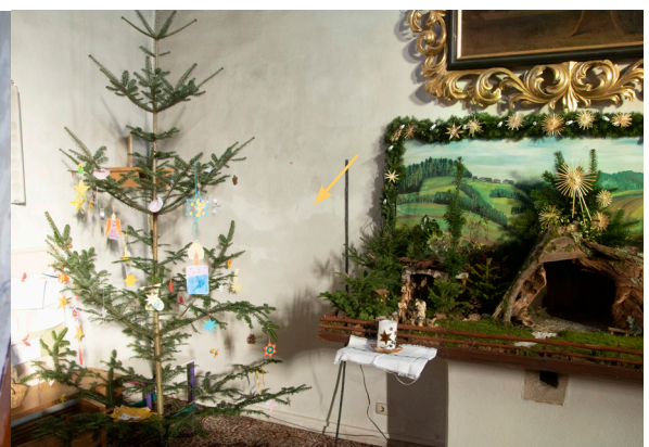
Abb. 21 Feuchtflecken, kirchenschiffseitige Chorwand (IMG_9509.tif)
