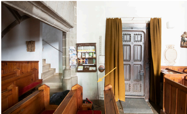
Abb. 41 Salzbelastete Sockelzone an der westlichen Kirchenschiffnordwand (IMG_9487.tif)
