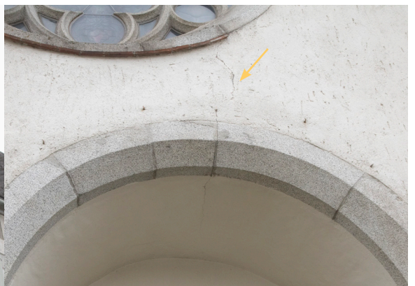
Abb. 09 Statischer Riss über Eingangsbereich an der Kirchenschiffnordfassade (IMG_9452.tif)
