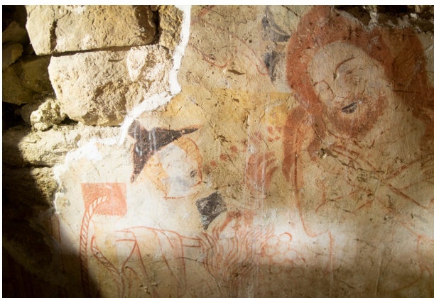
Abb. 46 Salzbelastete Sockelzone an der westlichen Kirchenschiffnordwand (IMG_9429.tif)
