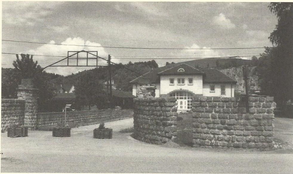
Das ehemalige „Jourhaus“ des KZ Gusen während des Umbaus zu einem Einfamilienhaus, 1995. (Bertrand Perz)
