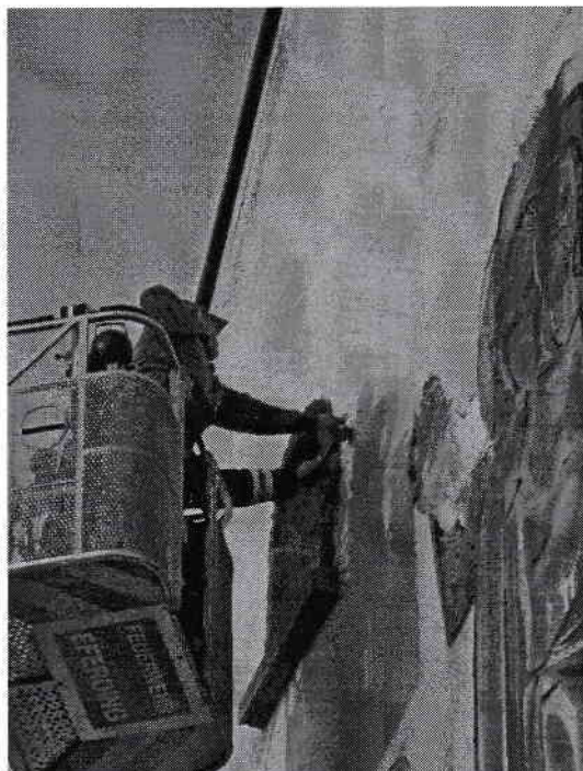
DEUTLICH SICHTBARE SPUREN DER MAUERSCHÄDEN
