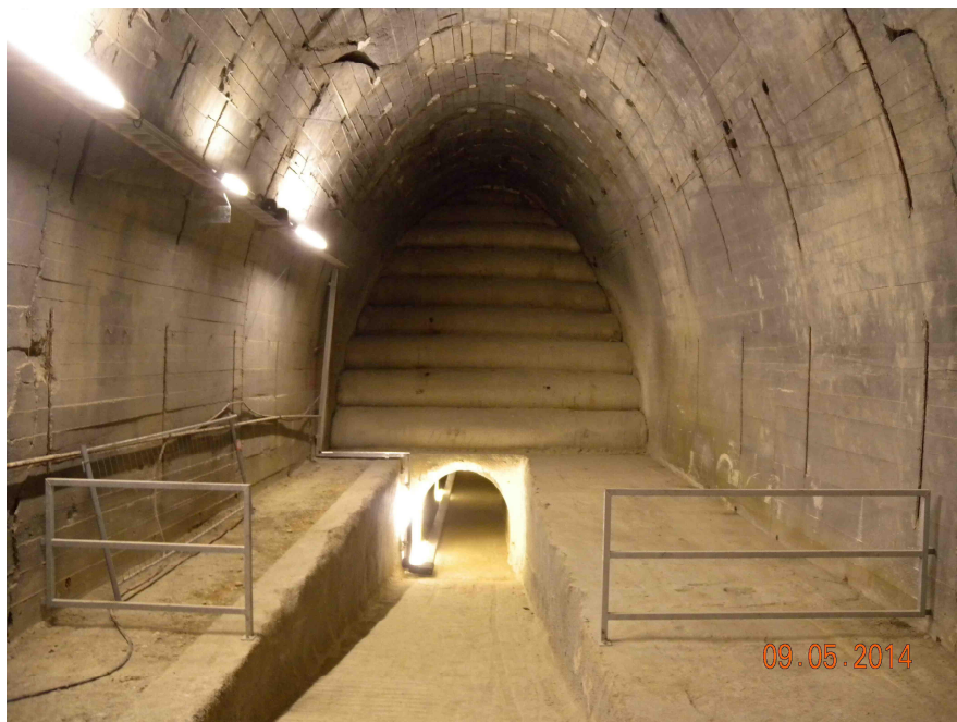
Foto: S Consult Management GmbH (i.A. der BIG): Bild stammt vom Bereich Knotenpunkt A4 bis A 8 . Kollektorgang aufgeschnitten, um eine Zugänglichkeit unter den gesicherten Verbrüchen zu erhalten.
