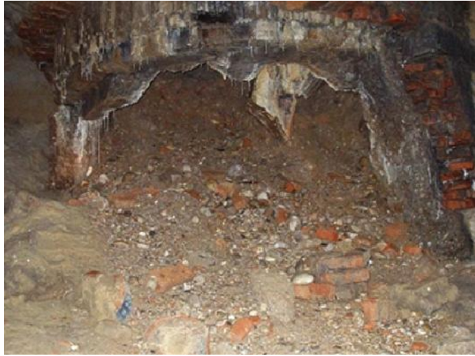
Abbildung 2: Fotodokumentation Schachtfuß vom 11.10.2007, ausgeflossenes Verfüllgut, bestehend aus Kiessanden mit Fragmenten des Schachtbaues; bergseitig: Ziegelausbau: hohlraumseitig: Schalbeton
