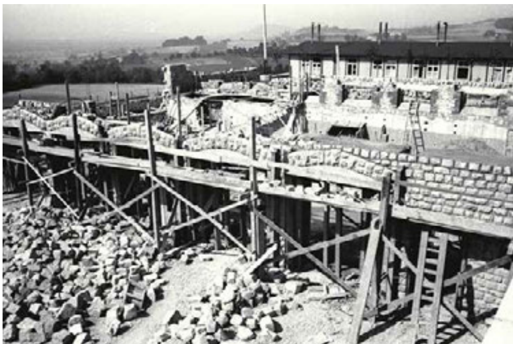
Der Bau des sog. Garagenhofes des KL Mauthausen im Jahr 1941. Quelle: Bundesarchiv, Bild 192-180 Fotograf: unbekannt
