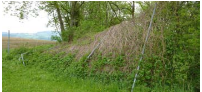
Der reparaturbedürftige Zaun
