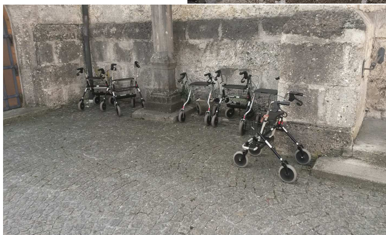
Vor der Sanierung - Eingangsstufen
