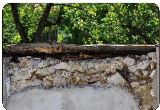
Der Zustand der Mauer im Detail
