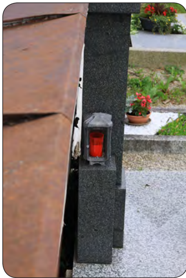
Die Neigung der Mauer ist bereits beträchtlich
