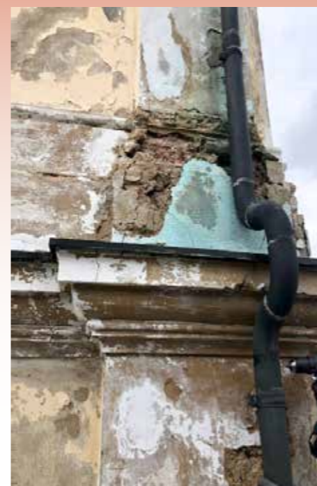
<--- Wasserschaden am Kirchturm
