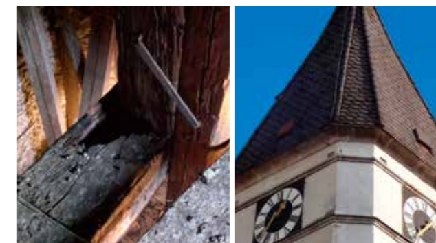
Im Inneren des Kirchturms sind schon erhebliche Schäden sichtbar. Auch an der Außenseite des Kirchturms lösen sich die Dachschindeln.
