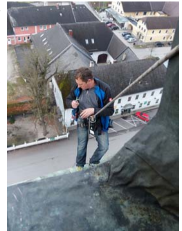
Andreas Mayerl (der Turmspengler, der in Hilkering die Arbeiten durchführte) bei der Untersuchung der Turmkuppel
