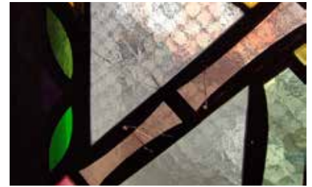
Schäden an einem der Glasfenster
