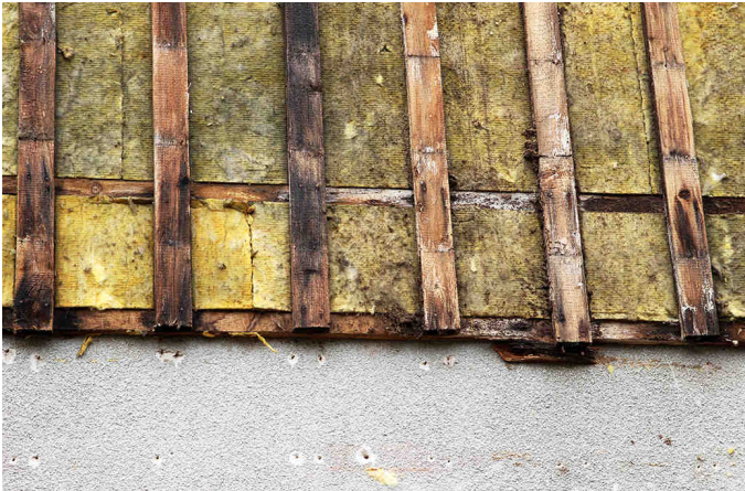
jetzt erkennbar ein Sanierungsfall
