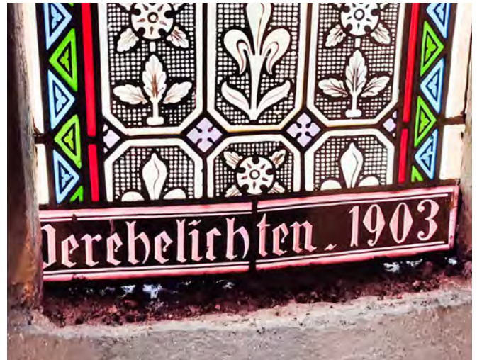
Dringender Sanierungsbedarf der Kirchenfenster
