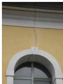
Die Mauer der Kreuzkapelle wölbt sich nach außen.
