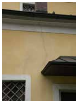
Sprünge in der Sakristeimauer abklären
