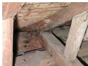
Einige Holzbalken sind verfault
