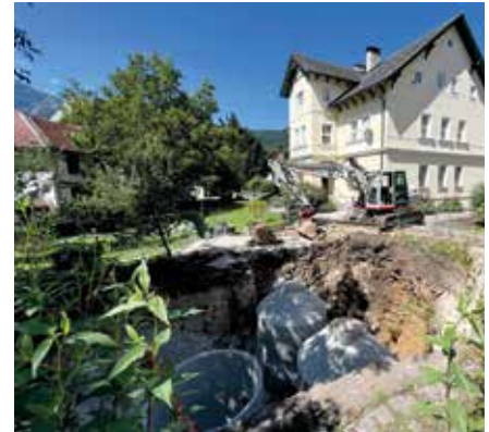
Die Sickerschächte verschwinden im Pfarrgarten
